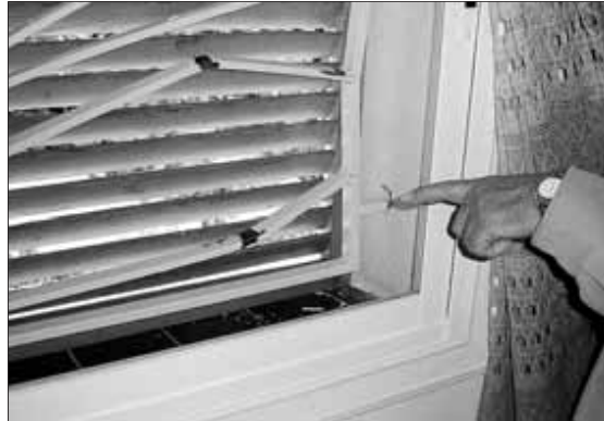
El propietario de la vivienda señala la reja que fue forzada para que los ladrones pudieran acceder a la vivienda. FOTO: JMB
